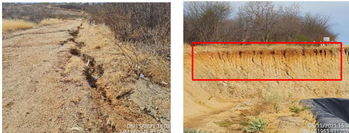
Figura 126 – (A) Erosão laminar com fluxo de solo em via de acesso no empreendimento; (B) Filetes de erosão em perfil de solo exposto por corte na ADA do empreendimento.
