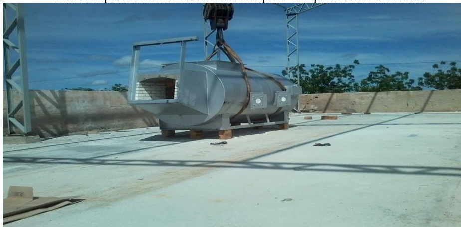
Figura 58 – Uma das câmaras do forno incinerador nas dependências da empresa CRIL Empreendimento Ambiental na época em que este foi montado.
