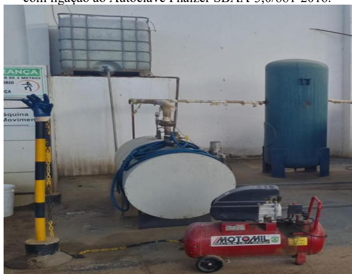
Figura 12 – Gerador de vapor do tipo Flamotubular – caldeira com ligação ao Autoclave Fhaizer SBAA-3,0/881-2016.
