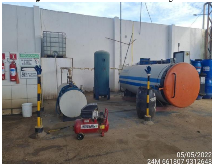
Figura 11 – Vista do sistema de autoclavagem.
