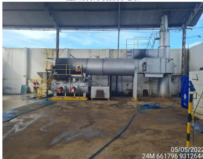
Figura 55 – Incinerador de câmaras cilíndricas IEN.100.CCH.AC-LG.
