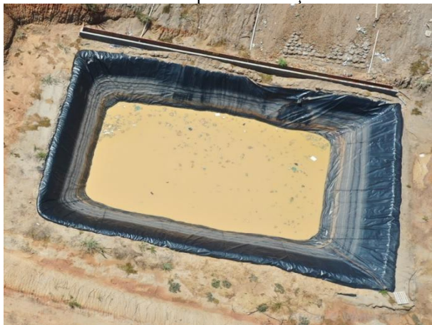
Figura 17 – Lagoa de chorume para processo de tratamento por desidratação.
