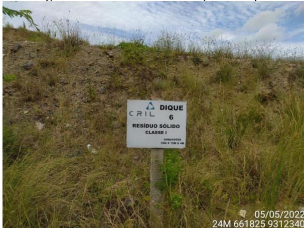
Figura 31 – Placa de identificação do dique.
