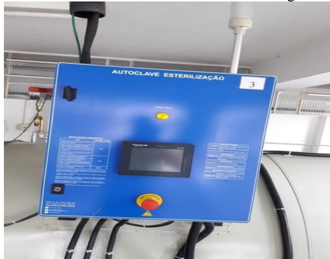
Figura 13 – Controlador de comando - Controlador Lógico Programável
